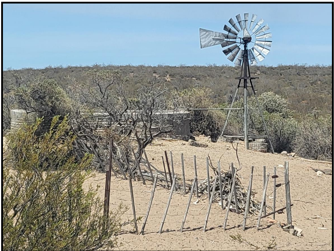
FOTO N° 2: Molino y tanque de almacenamiento de agua en uso
